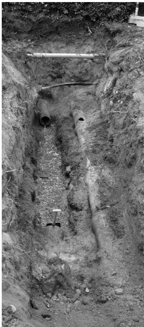
• Bild från det pågående reparationsarbetet. Ett snabbt larm räddade föreningen från vattenskador när ett avloppsrör brast sedan kraftiga trädrötter vuxit in i systemet och vållat stopp.
