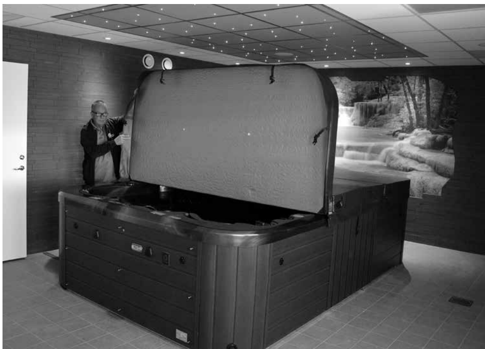
• Föreningens nya bubbelpool är på plats och är testkörd. Håkan Lundgren demonstrerar. Locket är till för att isolera och minska värmeförbrukningen mellan doppen.
